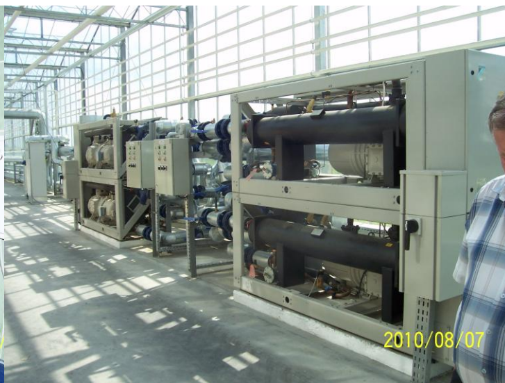
Рисунок 2 – Тепловые насосы фирмы Daikin, геотермальной станции «Берестье».
