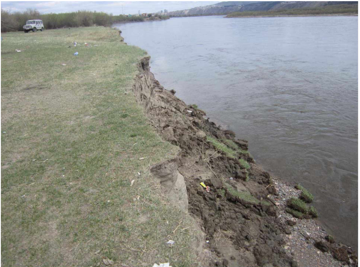
Рис. 1.2.2.2.2. Эрозионное разрушение берега на участке «Сужа»
