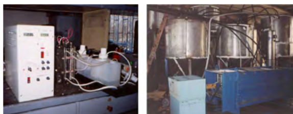
Рис.2. Экспериментальная и промышленная электроэкстракционные установки
