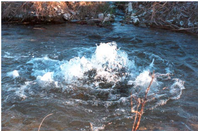
Рис. 5. Плотина Ла Амистад (Мексика – США). Свищ в дне водохранилища
