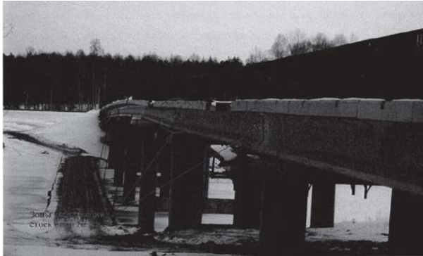
Рис. 4. Деформация мостового перехода через реку Сосьву
