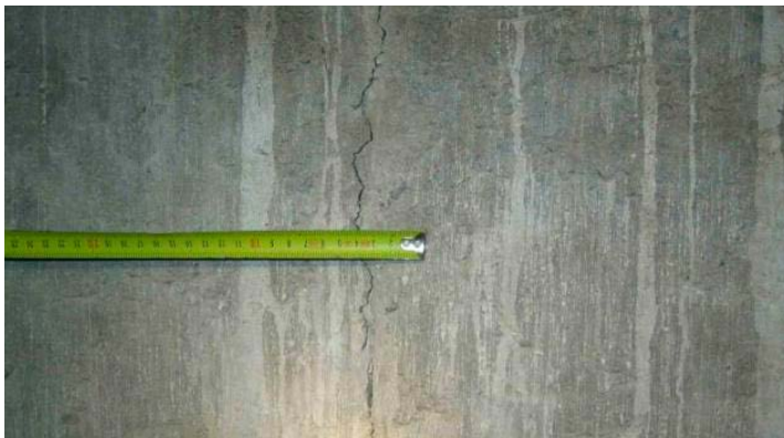
Рис. 1. Вертикальная трещина в железобетонной крепи ствола «Южный Вентиляционный» в интервале глубин 40–52 м
