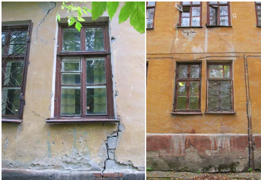
Рис. 2. Повреждения здания травматологии в г. Нижний Тагил (фото Усанова С. В.)
