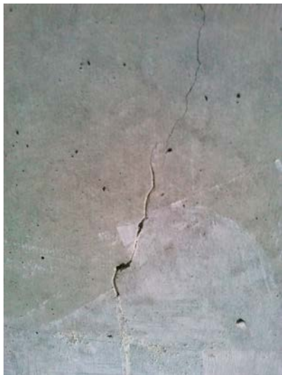
Рис. 12. Обнаруженная трещина во внутренней стене здания
