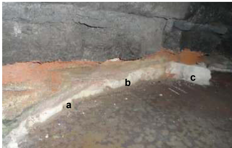
Рис.7. Огнеупор и изоляция под блоком в центре электролизера: а) СНМ, пропитанный электролитом; б) CaSi пропитанный электролитом; в) в центре осталось еще 8 см непропитанного электролитом CaSi
