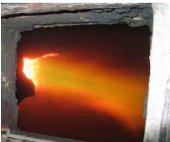
Рис. 3. Вид на переходник аптейк –котел-утилизатор в декабре 2016 года (со стороны смотрового окна КУ)
