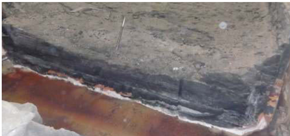
Рис. 4. Расслоение катодных блоков в трехлетнем электролизере, повлекшее разрушение из-за высокого содержания железа
