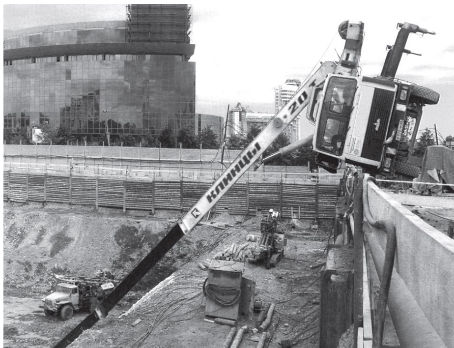
Рис. 1. Опрокидывание стрелового самоходного крана при строительстве котлована
