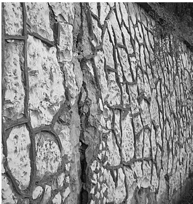
Рис. 1. Деформации подпорной стенки автодороги М-27 Джубга – Сочи
