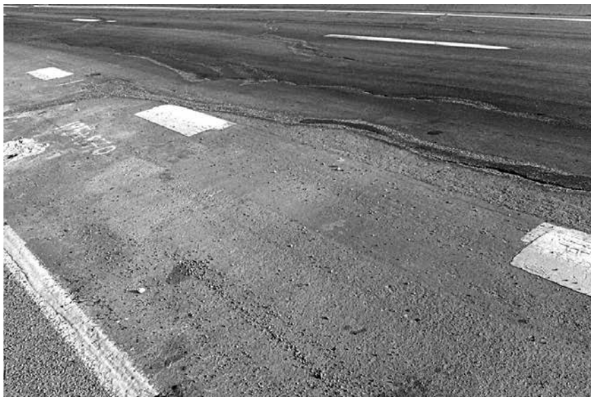
Рис. 2. Деформации (развитие продольных и поперечных трещин) дорожного полотна автодороги М-27 Джубга – Сочи
