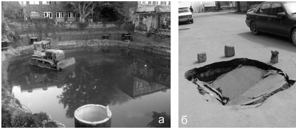
Рис. 3. Выход грунтовых вод в котловане строящегося здания (а) и провал грунта над кyarизом (б)
