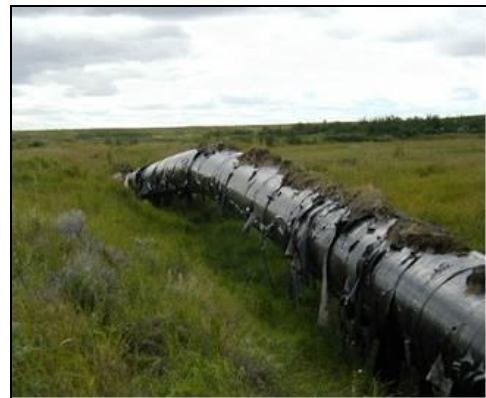
Рис.5. Выпучивание трубопровода с последующей осадкой поверхности под ним (фото Я.В.Пановой)
