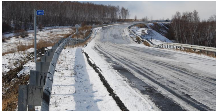
Рис.4. Состояние автодороги «Амур» на переходе через руч. Чичон, 247 км, 19 октября 2014 г.
