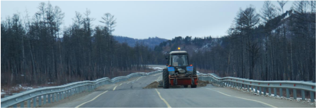
Рис. 1. Состояние автодороги «Амур» на одном из участков деградации многолетней мерзлоты в её основании, Забайкальская часть дороги, 19 октября 2014 г.
