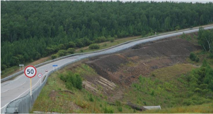
Рис.3. Состояние автодороги «Амур» на переходе через руч. Чичон, 247 км, 16 августа 2013 г.
