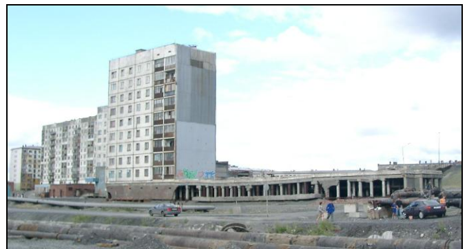
Рис.6. Норильск. Деформированный криогенными процессами фундамент разобранных секций 9-этажного здания (фото Д.С.Дроздова)
